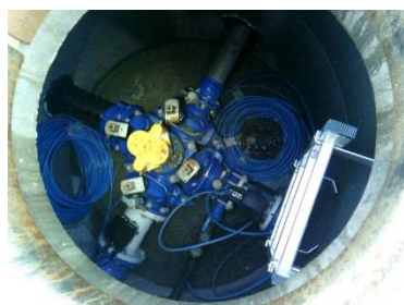
Avansert ventilkryss Sandabekken
