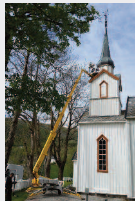
Det ble i vinter oppdaga vannlekkasje i tårnet i Lensvikkirka. Bildet er fra reparasjonsarbeidet.
